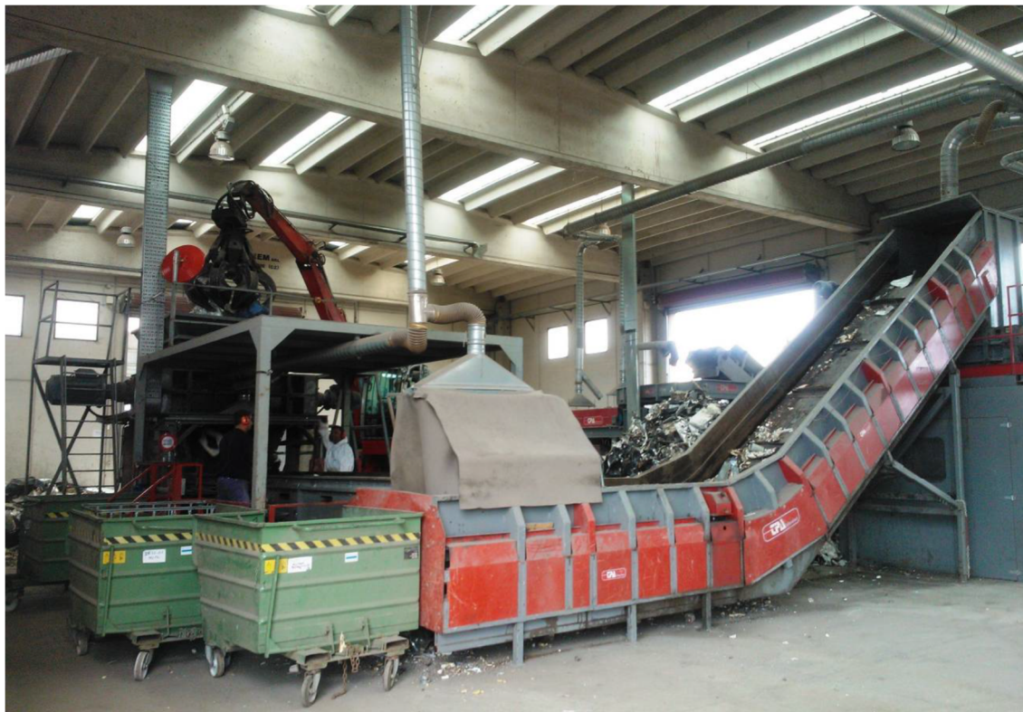
Figura 3.1 – Impianto di trattamento RAEE e metalli
