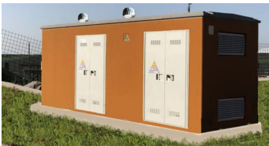
Figura 21 - Cabina di elettrica prefabbricata tipo DG2061 Ed.09
