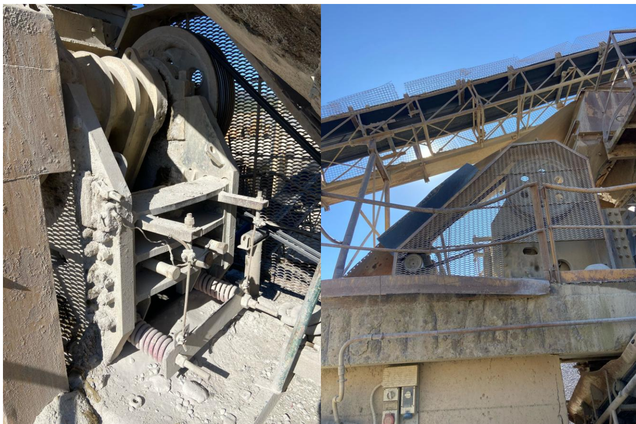
Figura 7_ Impianto di frantumazione OMT Spa_matricola 1489
