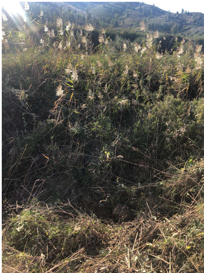
Figura 10 - Foto n.5 – Alveo a valle della vasca completamente ostruito dalla vegetazione
