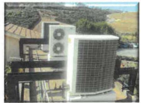
Figura 10 – Pompe di calore
