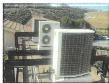
Figura 10 – Pompe di calore
