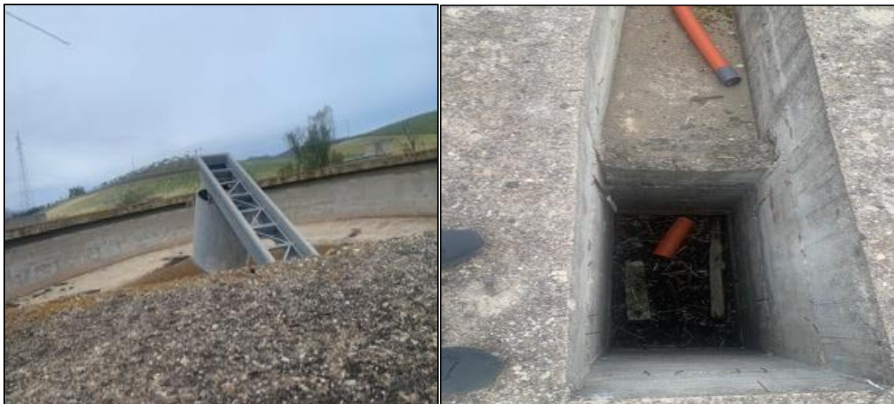
Foto nn. 1- 2. Stato di degrado delle strutture presenti in Località Vattiato
