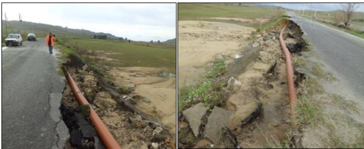
Foto nn. 3- 4. Stato di dissesto della condotta di adduzione dei reflui verso Località Vattiato
