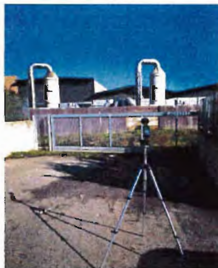
R4 – Lato Ovest -Biofiltro
