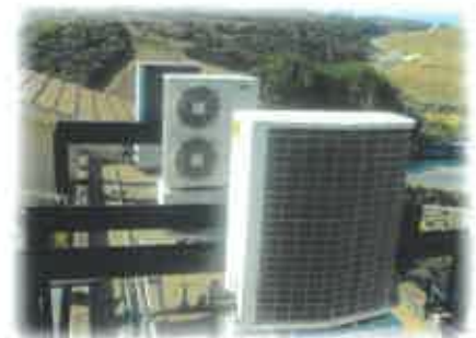
Figura 10 – Pompe di calore
