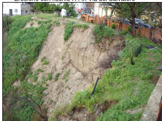
Erosione con rischio R4 in Via del Salvatore
