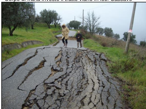
Corpo di frana investe il tratto viario in loc. Cassavo
