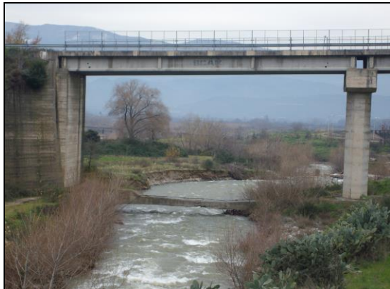
Briglia scalzata sul Fiume Mucone e ponte sulla ex S.S. 660
