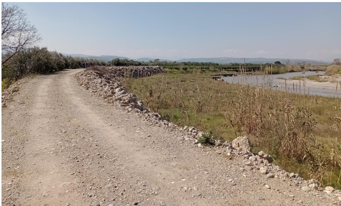
Figura 18 – Punto di rottura d'argine 23 novembre 2018 e Intervento di emergenza ed Intervento 2019. Vista da valle verso monte
