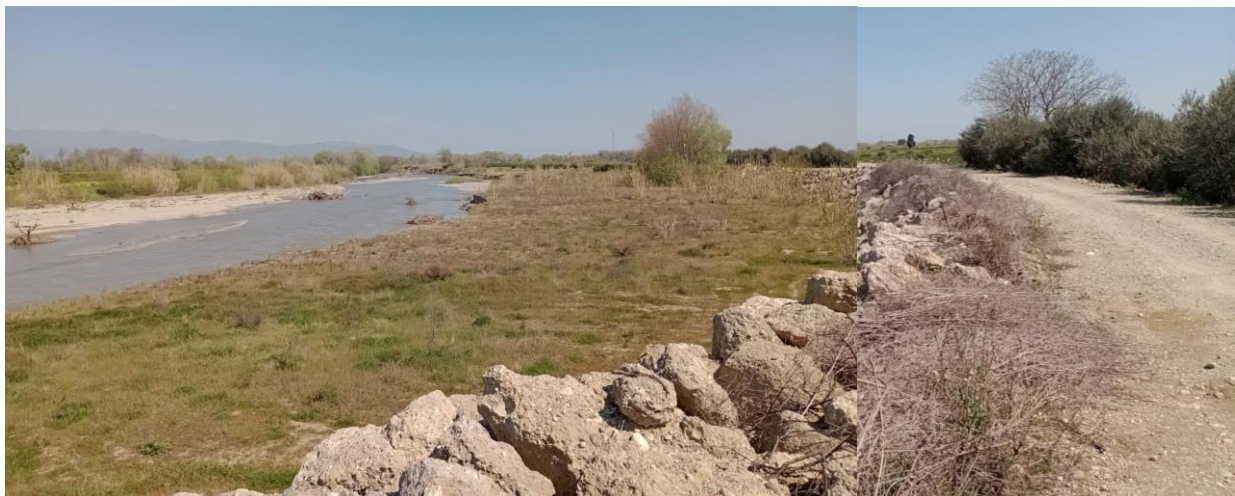
Figura 20– Punto di rottura d'argine 23 novembre 2018 e Intervento di emergenza ed Intervento 2019. Vista da monte verso valle
