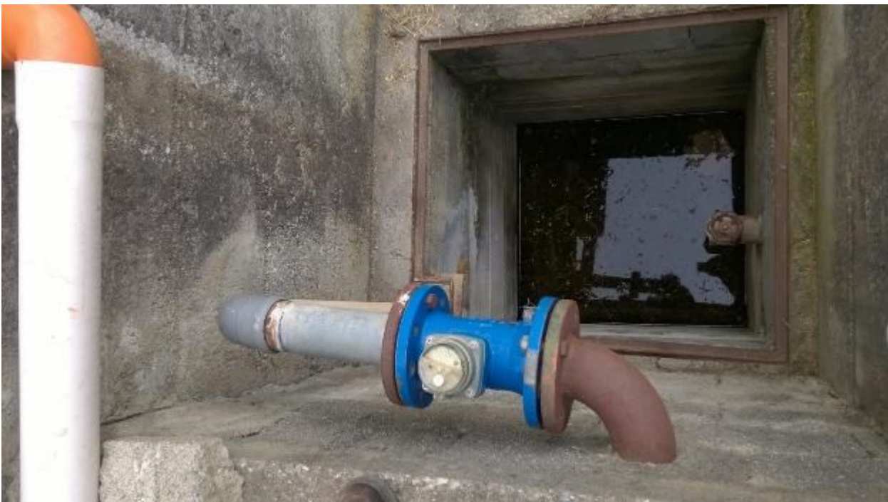
Figura 3: Pozzetto di scarico dell'impianto
