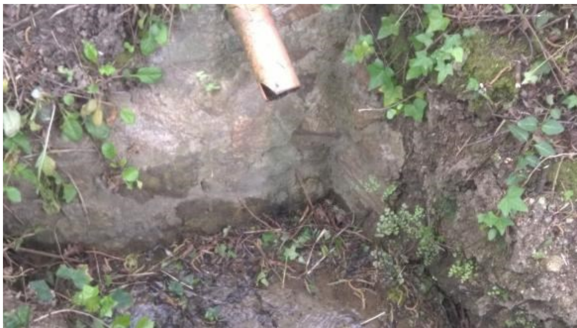
Figura 4: Versamento della condotta di scarico all'interno dell'Asta del torrente Lavandaia
