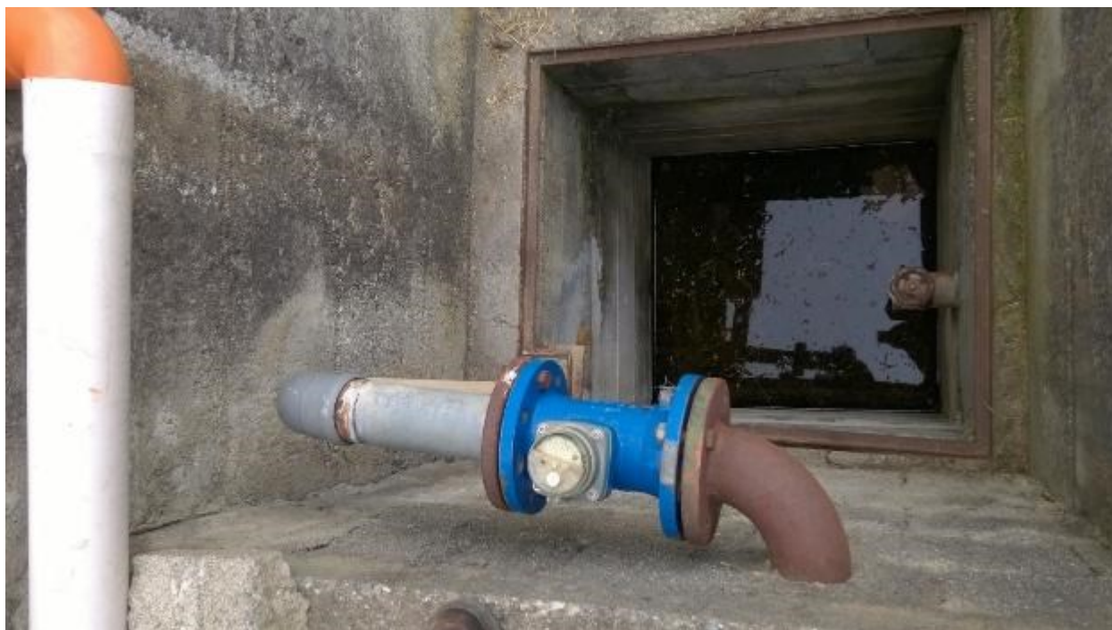
Figura 3: Pozzetto di scarico dell'impianto
