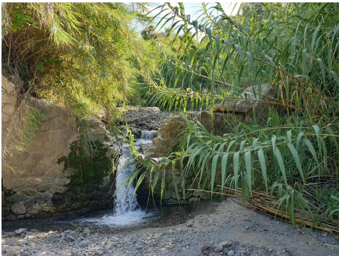
Figura 6. Briglia ammalorata nel tratto di monte.
