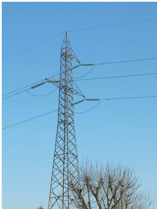
Figura 4.1.13 – Foto di un traliccio per linea aerea AT.
