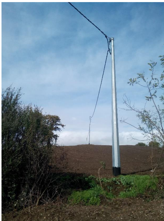
Figura 4.1.11 – Foto di un palo per linea aerea MT.
