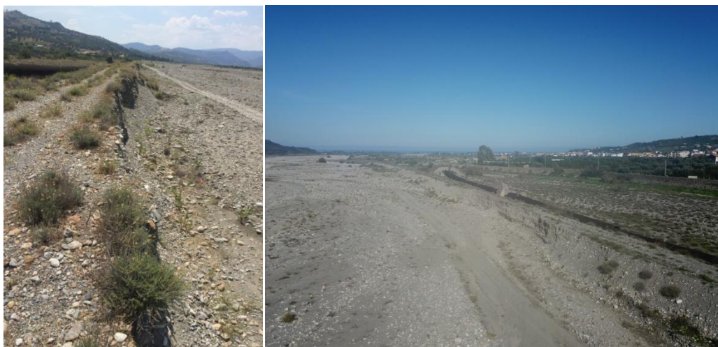
Figura 12 - Segni di erosione degli argini in terra esistenti
