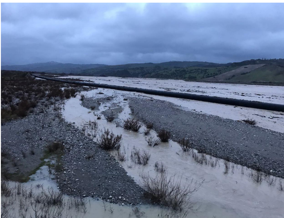
Figura 10 - Evento di piena: l'acqua fluisce sotto il tubo - foto storiche Ufficio Tecnico
