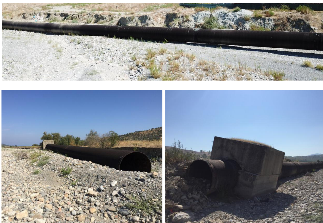
Figura 4 - Tubi condotta in disuso complesso Trionto - Diga Laurenzana
