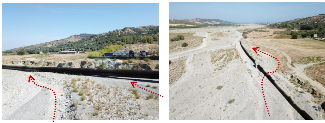
Figura 7 - Punto critico: il tubo emerge e il fiume si insinua al di sotto di esso
